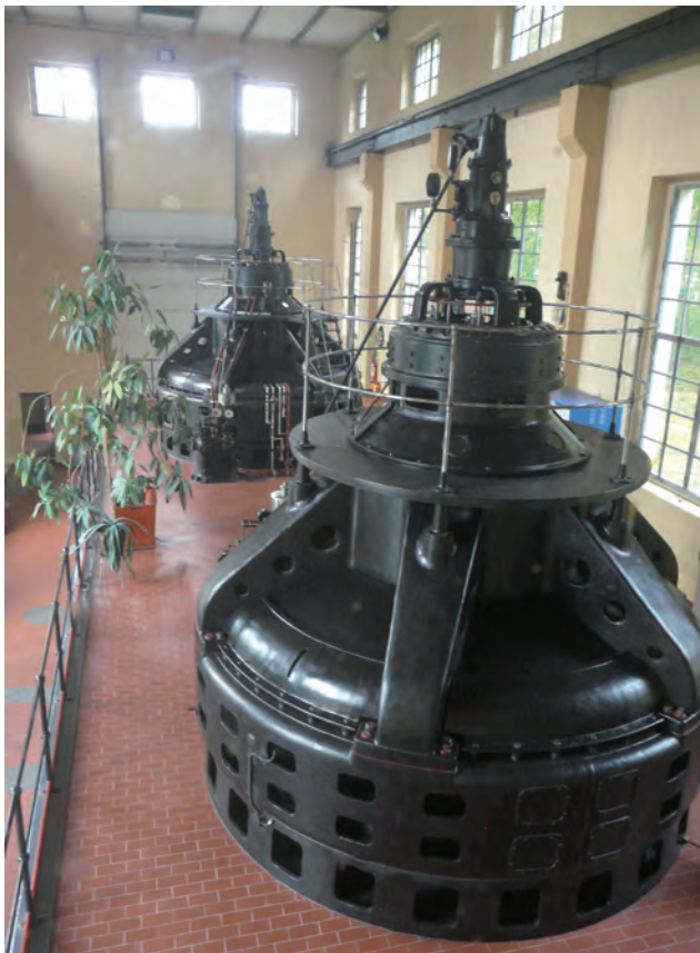
Generator turbiny Kaplana EW Żur. Fot. P. Schreiber
