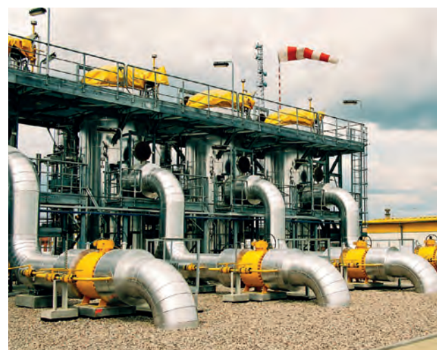
Tłocznia Gazu Ciechanów. Fot. arch. EuRoPol GAZ s.a.
