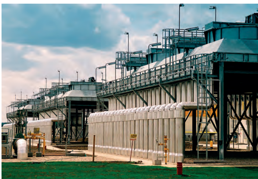
Tłocznia Gazu Ciechanów. Fot. arch. EuRoPol GAZ s.a.
