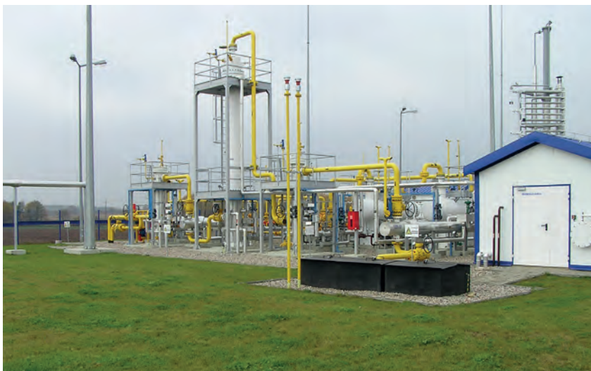
Złoże Daszewo od 2009 r. wykorzystywane jest jako podziemny magazyn gazu, jest to jeden z nielicznych tego typu obiektów, w których gaz magazynuje się w szcerpanym złożu ropy naftowej. Fot. archiwum Oddziału.
