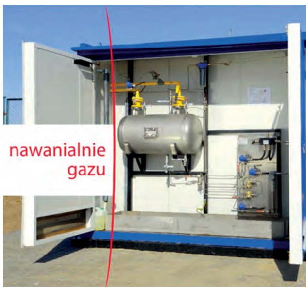
Rys.1. Przykładowa lokalizacja instalacji do nawaniania gazu
