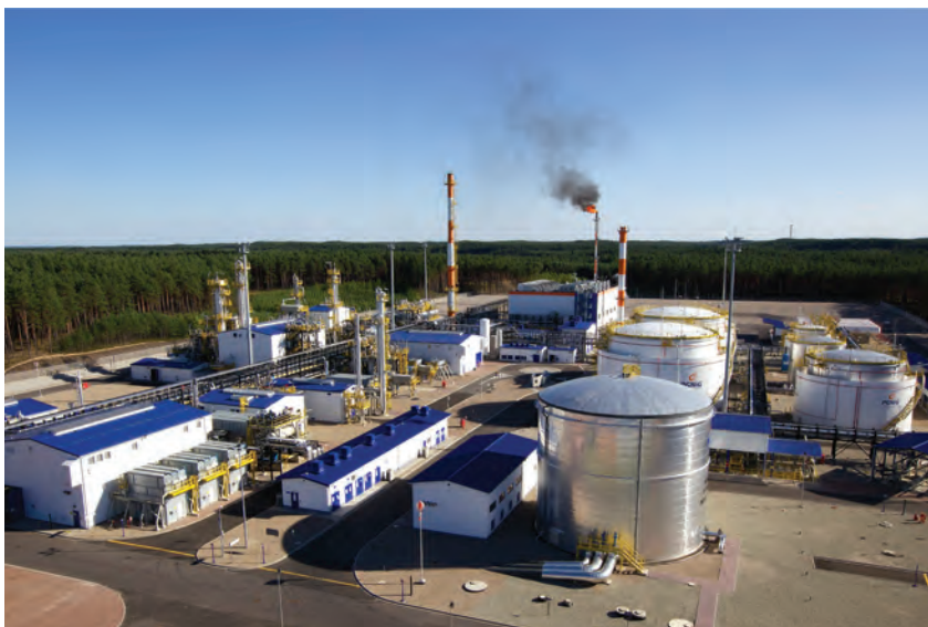
Ośrodek Centralny Lubiatów zaprojektowany jest w sposób umożliwiający produkcję 1,3 tys. ton ropy na dobę, 30 tys. m 3 gazu na godzinę, 144 ton LPG z kondensatem C5+ i 120 ton siarki na dobę. Fot. Grzegorz Kujda
