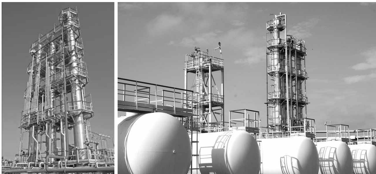
Fot.2 i 3. Instalacja rozpuszczalników (fot. ze zbiorów autora).
