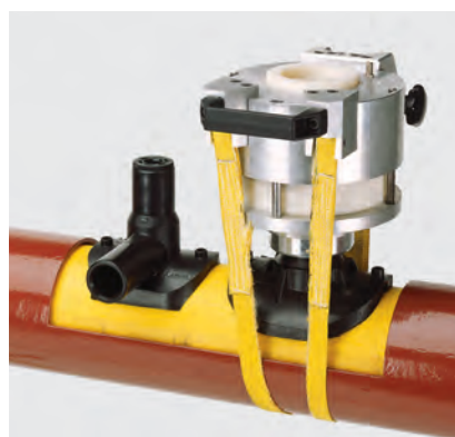
Fot. 9. Montaż siodła elektrooporowego przy pomocy urządzenia FRIATOP (top-loading) w przypadku renowacji gazociągów
