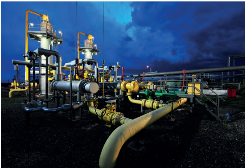
Kolumnowa instalacja osuszania gazu na PMG Husów nocą. Fot. arch. PGNiG SA – Oddział w Sanoku
