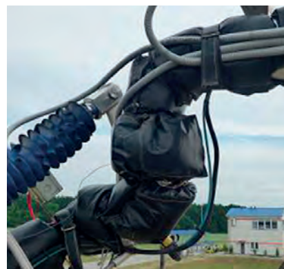
W celu zmniejszenia zagrożenia związanego z wysoką temperaturą stosowane są dodatkowe zabezpieczenia w postaci izolacji termicznej lub dodatkowej osłony – osłona termoizolacyjna części nalewaka. Fot. arch. PGNiG SA Oddział w Zielonej Górze
