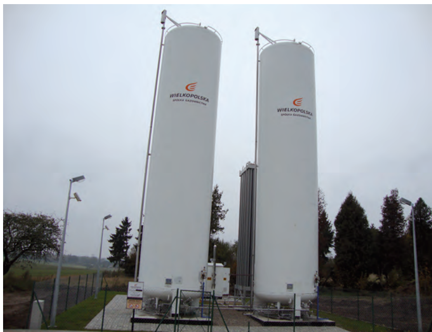
Instalacja regazyfikacji LNG w Ińsku. Fot. arch. WSG
