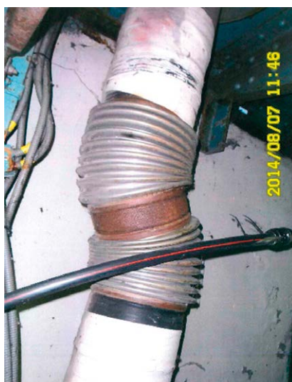
Rys. 1. Uszkodzenie kompensatorów mieszkowych zamontowanych na gazociągu podwieszonym pod wiaduktem Fig. 1. Damage to bellows compensators installed on the gas pipeline suspended under the viaduct
