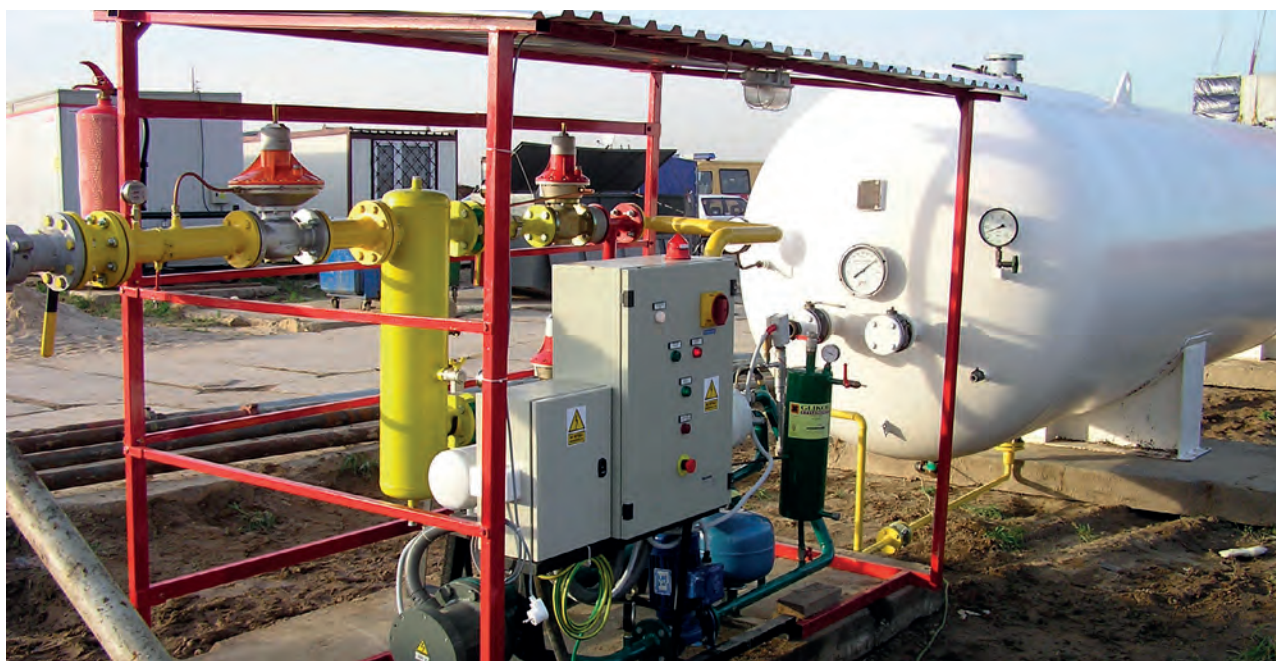
Rys. 2. Instalacja do dopalania gazu - parownik i zbiornik 25 m 3 - odwiert C-2
