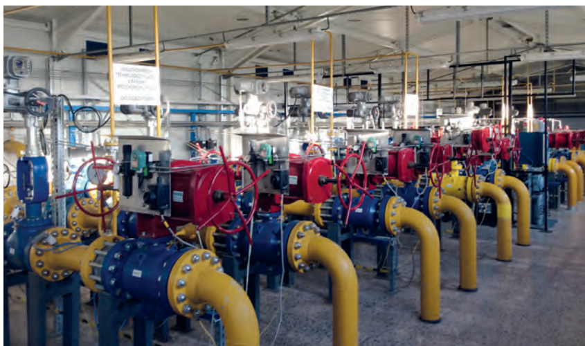
Odcinki pomiarowo-regulacyjne. Fot. archiwum Oddziału
