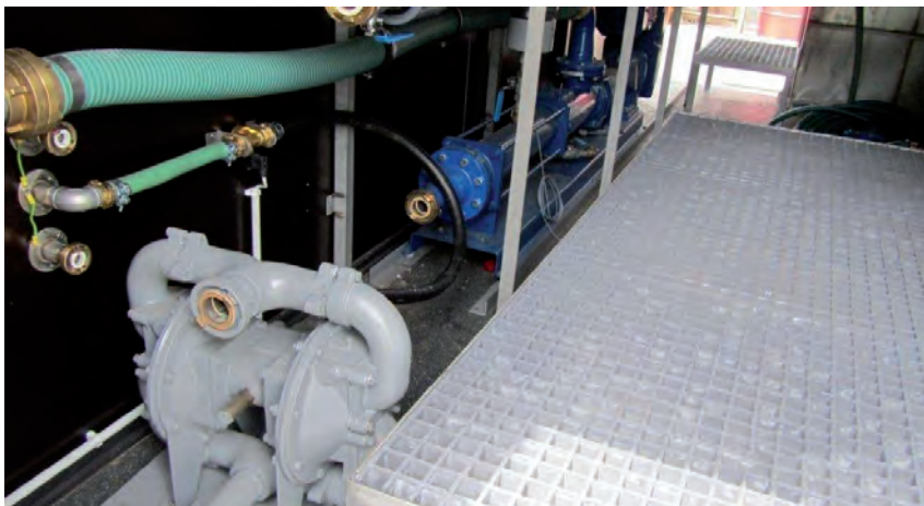
Stacja flokulacyjna zaprojektowana przez inżynierów Serwisu Płuczkowego na etapie budowy i doposażania w osprzęt. Fot. arch. PN „Diament” Sp. z o.o.
