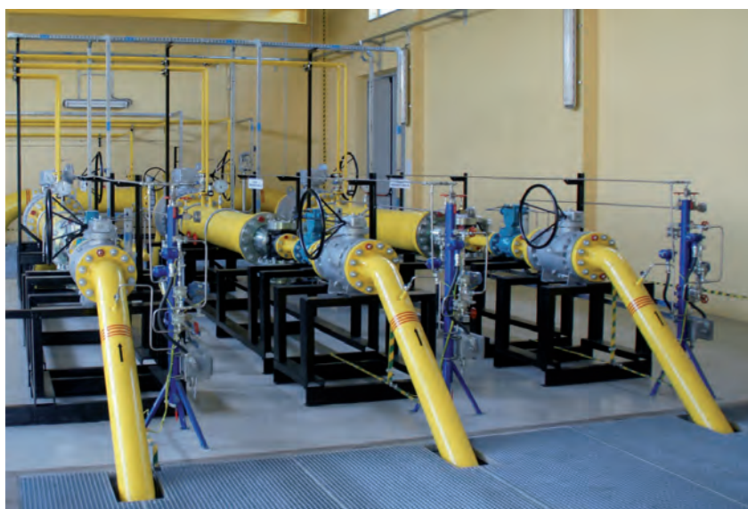
Ilustracja 4. Ciągi redukcyjne z widocznymi pneumatycznymi jednostkami wykonawczymi systemu LC-21
