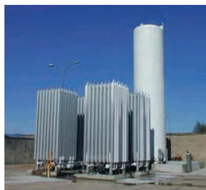
Rys. 3b. Zbiornik LNG i parownice [8]
